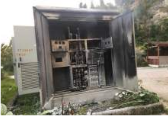
Çamlık Mah.25:Nolu Trafo Yangını
