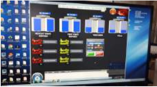
Aktif otomasyon sistemiyle depoların doluluk oranları izlenebilmekte, olası bir arıza ve su taşıma durumunda anında müdahale edilebilmektedir.
