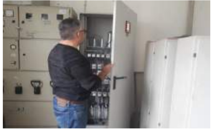
Çalıcı Konutlar Terfi Merkezi ile Kuru Terfi Merkezleri'nin trafo periyodik bakımları yapılmıştır.
